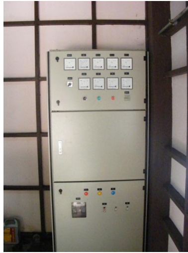
ภาพที่ ค.3 แผงควบคุมการจ่ายไฟฟ้า ของโครงการไฟฟ้าพลังน้ำระดับหมู่บ้าน โครงการแม่กำปอง 1 และ 2
