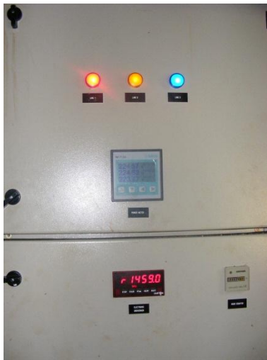
ภาพที่ ง.5 แผงควบคุมการจ่ายไฟฟ้า ของโรงไฟฟ้าพลังน้ำแม่มอญ
