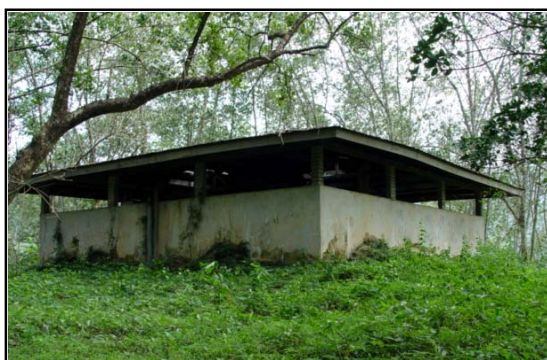
ภาพที่ 92 โรงสูบน้ำและถังเก็บน้ำบนเนินแปลงทดลองยางพารา
