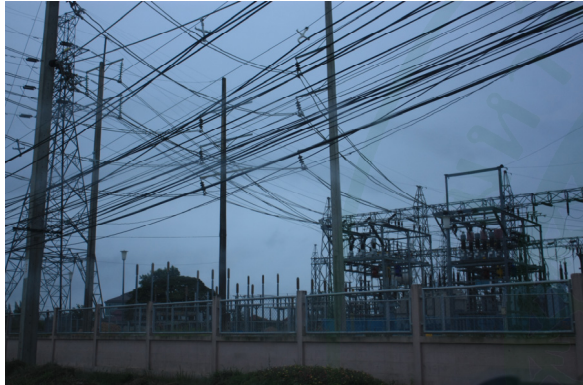
สถานีไฟฟ้า
