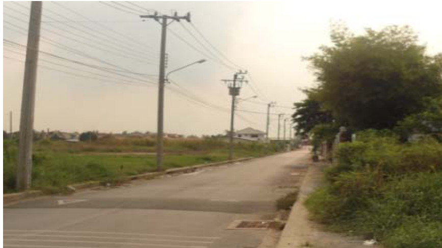
ภาพที่ 16 สภาพแวดล้อมแบบที่ 2 สมาร์ทมิเตอร์ติดตั้งอยู่บนเสาไฟฟ้า ระดับความสูง 1-2 เมตร จากพื้นดิน ตามแนวถนนขนาด 4 ช่องจราจร บริเวณทางเข้าหมู่บ้าน หรือชุมชน ซึ่งการกำหนดการติดตั้งอุปกรณ์ในการทดลองของแบบที่ 2 นี้ จะคล้ายๆ แบบแรก แตกต่างกันที่ตำแหน่งสมาร์ตมิเตอร์จะอยู่กลางแจ้ง ไม่มีอาคาร สิ่งก่อสร้างอยู่ใกล้แนวรับส่งสัญญาณ
