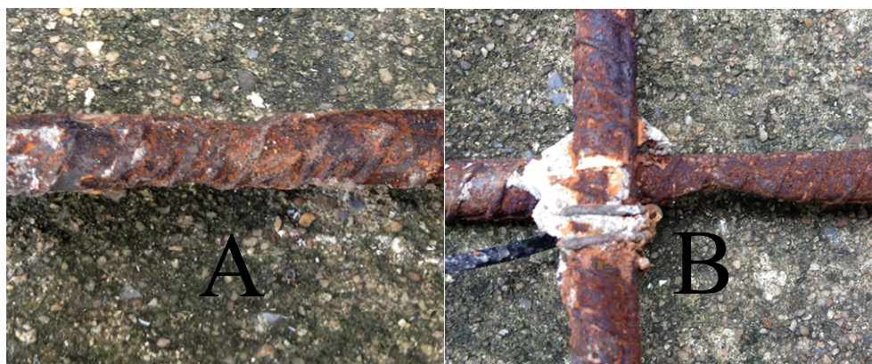
ภาพที่ 67 สภาพเหล็กเสริมของตัวอย่างชนิดเคลือบอีพ็อกซีบริเวณที่เกิดสนิมแบบหลุม
