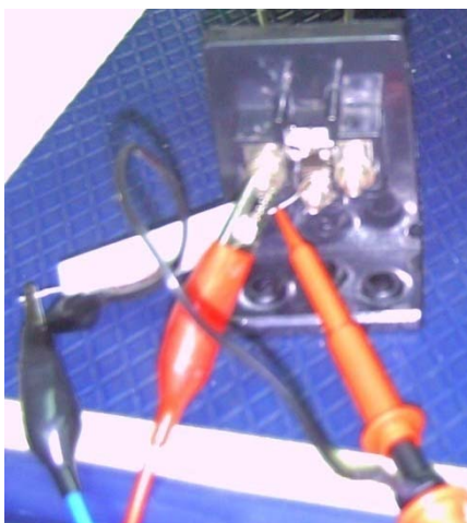
ภาพที่ 59 ภาพแสดงการทดสอบหาขนาดกระแสที่ไหลผ่านอุปกรณ์ป้องกันแรงดันเกินที่ติดตั้งปลายทาง(หลอดคายประจุผ่านก๊าซ)ขณะที่อุปกรณ์ทำงาน
