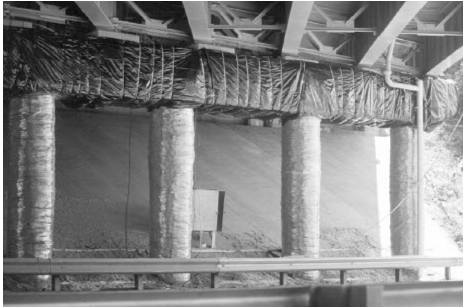
ภาพที่ ก6 แสดงการติดตั้งอุปกรณ์ในการติดตั้งอุปกรณ์ในการลดปริมาณคลอไรด์ใน โครงสร้าง ตอม่อสะพาน I-365
