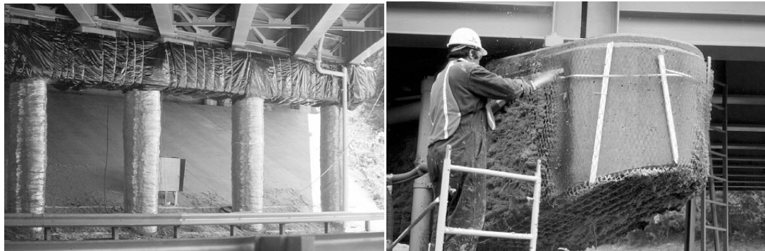
ภาพที่ 13 แสดงการประยุกต์ใช้วิธีทางไฟฟ้าเคมีในการลดปริมาณคลอไรด์ในคอนกรีต
