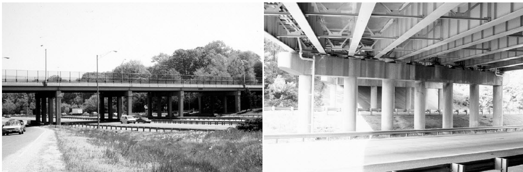
ภาพที่ ก1 แสดงลักษณะทางกายภาพของสะพาน I-365 (34 th Street Bridge Over I-365)
