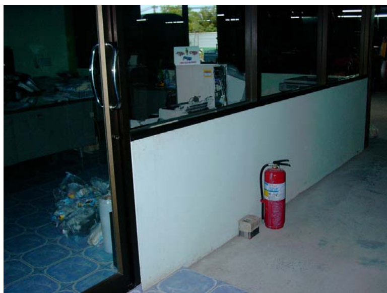
ภาพที่ 52 พื้นที่ในการจัดวางถังดับเพลิง
