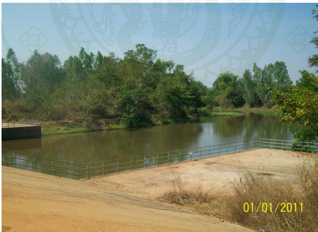
ภาพผนวกที่ ค2 ฝายน้ำล้นห้วยทา แหล่งน้ำสายหลักของหมู่บ้านทุ่งเลน
