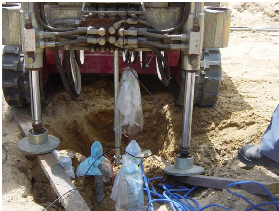
ภาพที่ 67 การติดตั้งอุปกรณ์วัดแรงดันน้ำด้วยระบบไฟฟ้าแบบเกษตรศาสตร์ (KU Piezometer)
