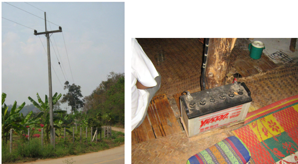
ภาพที่ 11 ภาพเสาไฟฟ้าที่ผ่านหมู่บ้านปางแดงนอกแต่ชาวบ้านไม่สามารถใช้ไฟฟ้าได้ ชาวบ้านหลายคนไม่มีไฟฟ้าใช้บางบ้านจึงใช้แบตเตอรี่รถยนต์ในการให้แสงสว่างแทน
