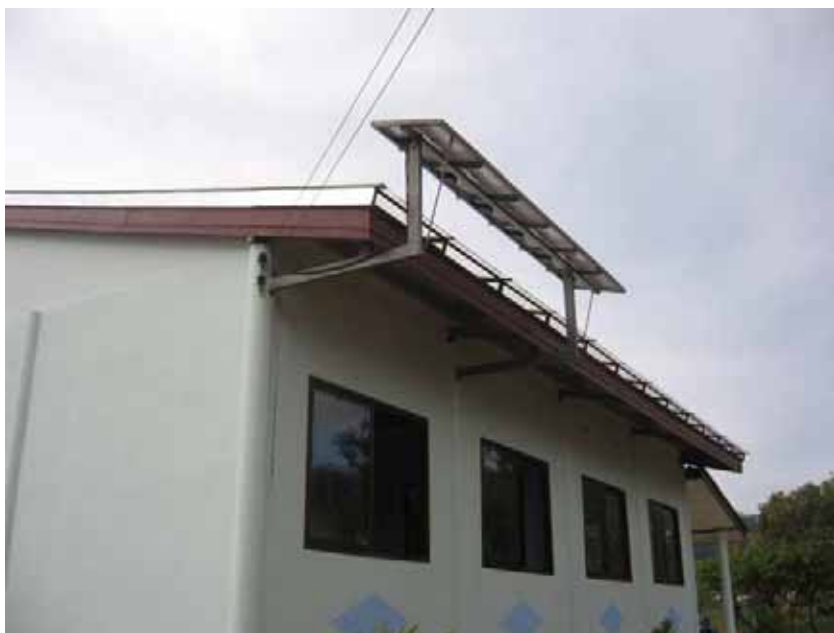
รูปที่ 3.12 ของแผงโซลาร์เซลล์ที่ติดตั้งบริเวณชายคาของโรงอบแห้งเพื่อจ่ายกระแสไฟฟ้าให้กับพัดลมระบายอากาศของระบบอบแห้ง
