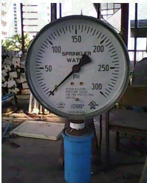
ภาพที่ 8 อุปกรณ์วัดความดันน้ำ (Pressure Gauge)
