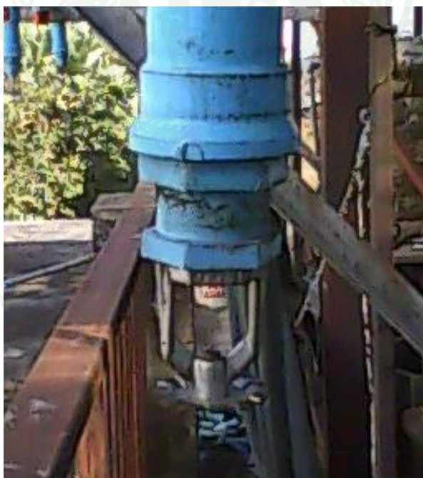
ภาพที่ 10 หัวกระจายน้ำดับเพลิง
