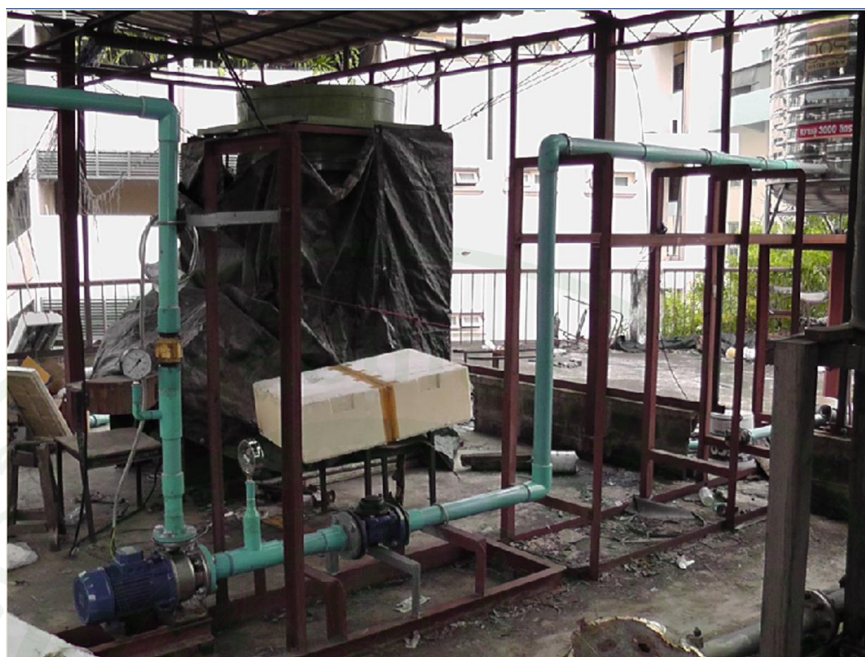
ภาพที่ 13 Piping Line
