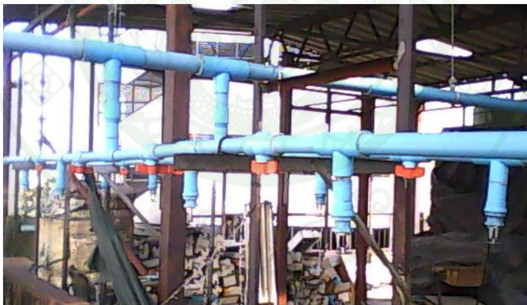
ภาพที่ 12 8 หัวกระจายน้ำดับเพลิงและ 8 บอลวาล์ว
