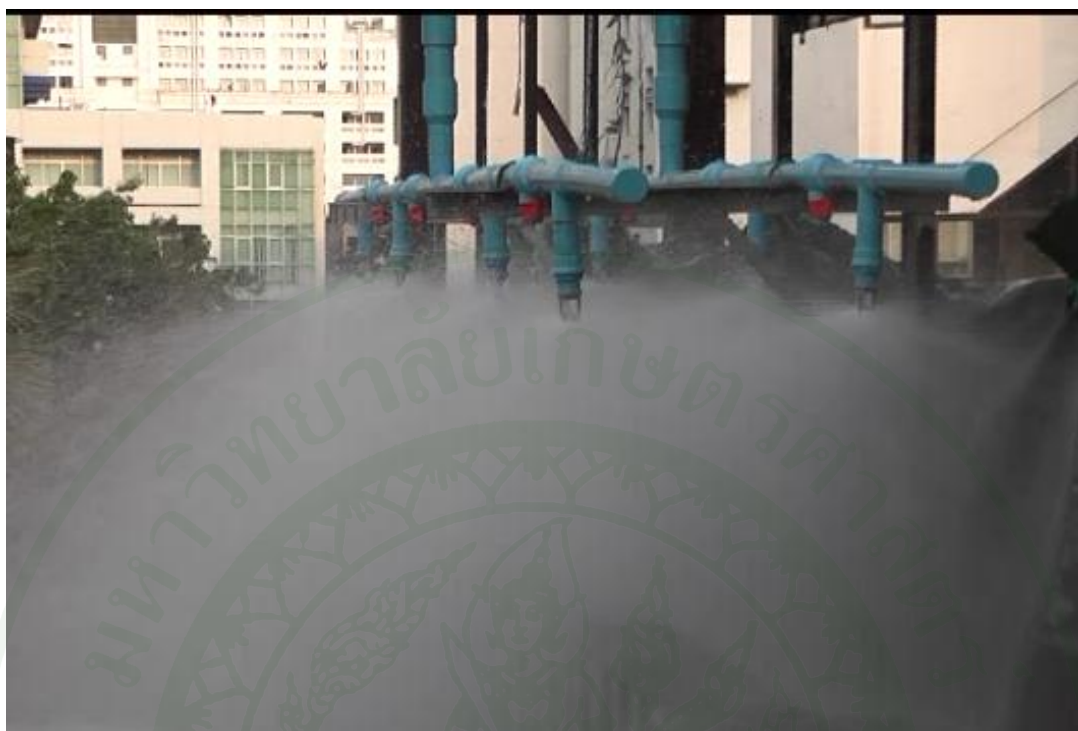
ภาพที่ 20 หัวกระจายน้ำดับเพลิงทั้ง 8 หัวทำงานที่ความถี่ 70 Hz
