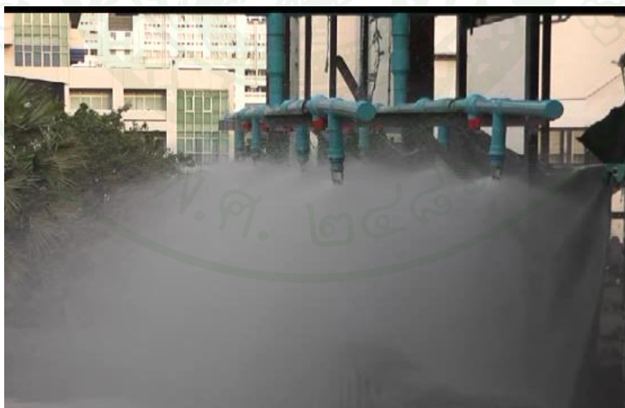
ภาพที่ 22 หัวกระจายน้ำดับเพลิงทั้ง 8 หัวทำงานที่ความถี่ 80 Hz
