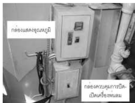
รูปที่ ข-9 แสดงลักษณะของตู้ควบคุมการทำงานของเครื่องพ่นลม และจอแสดงค่าของอุณหภูมิภายในเบ้าหลอม
