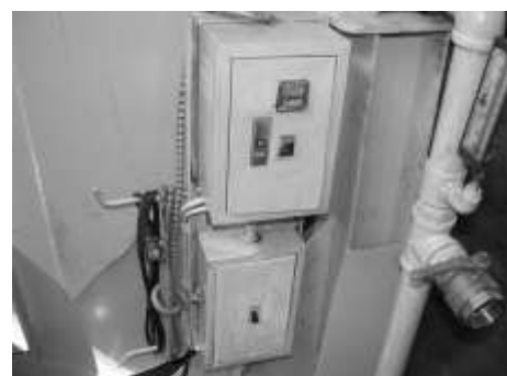
รูปที่ 3.21 ชุดควบคุมการทำงาน
