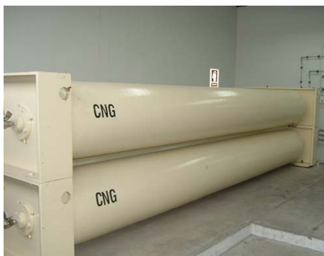
ภาพผนวกที่ ก 3 ถังเก็บและจ่ายก๊าซแบบ ASME ขนาดความจุ 1,200 ลิตร ที่มา: ถ่ายจากสถานที่จริง (2547)
