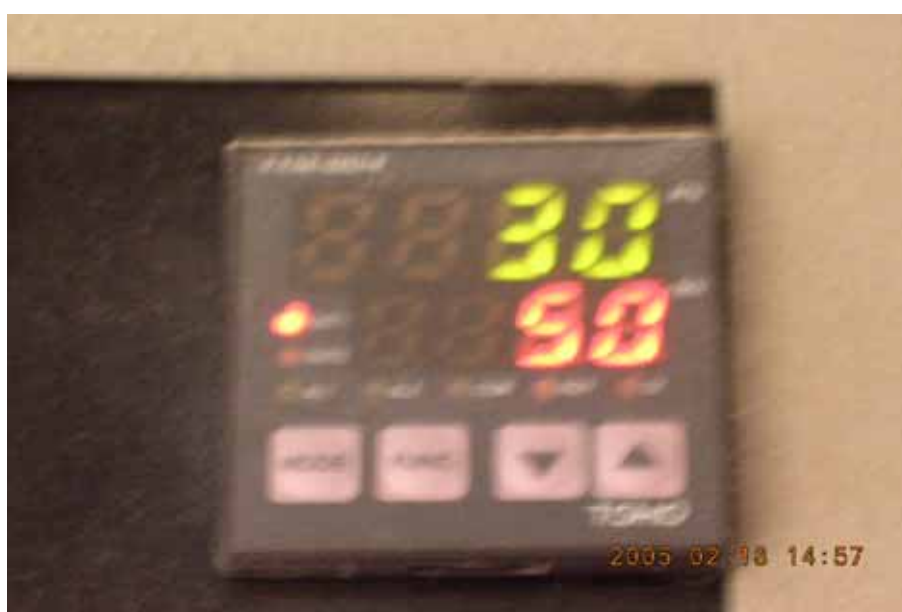
ภาพผนวกที่ ก8 แสดงตู้ควบคุมการทำงานของอุปกรณ์ตรวจจับความร้อน
