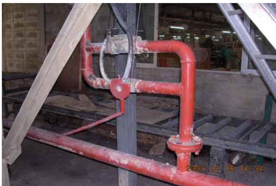
ภาพผนวกที่ ก10 แสดงขนาดท่อน้ำดับเพลิงที่เข้าสู่ถังเก็บฝุ่นไม้ในการระงับเหตุเพลิงไหม้
