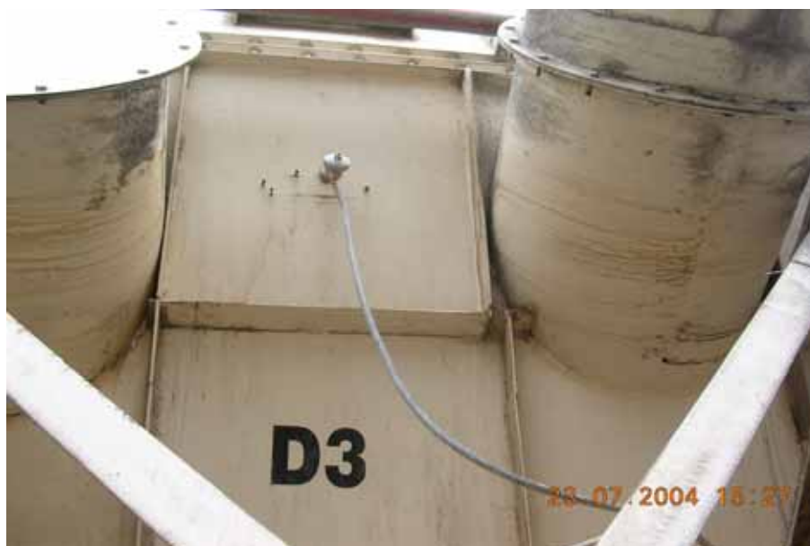
ภาพผนวกที่ ก7 แสดงตำแหน่งติดตั้งอุปกรณ์ตรวจจับความร้อนในถังเก็บฝุ่นไม้
