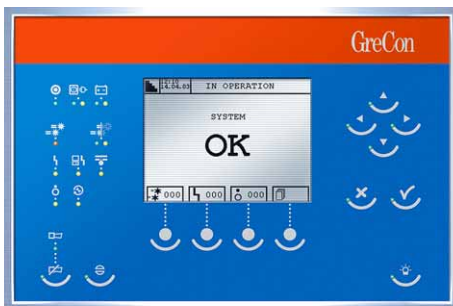
ภาพผนวกที่ ก16 แสดงรายงานการตรวจจับประกายไฟ จากตู้ควบคุมการทำงาน
