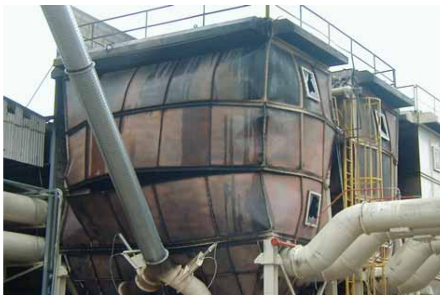
ภาพผนวกที่ ก2 แสดงถังเก็บฝุ่นไม้ที่เกิดเพลิงไหม้และการระบิดของฝุ่น
