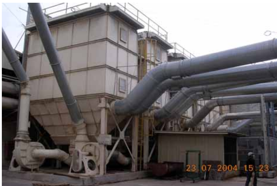
ภาพผนวกที่ ก1 แสดงถังเก็บฝุ่นไม้ที่ทำการวิจัยการติดตั้งอุปกรณ์ตรวจจับเพลิงไหม้
