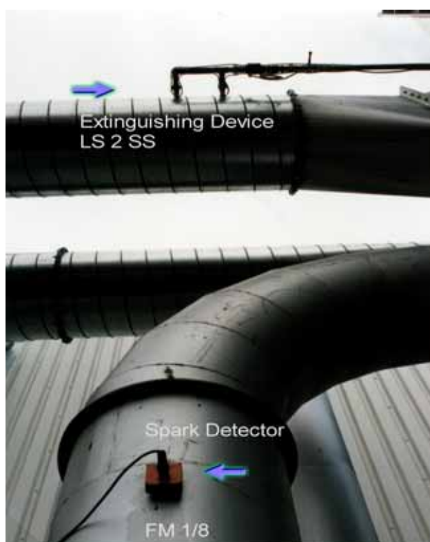
ภาพผนวกที่ ก20 แสดงการติดตั้งอุปกรณ์ตรวจจับประกายไฟและท่อน้ำดับเพลิงในท่อดูดฝุ่น
