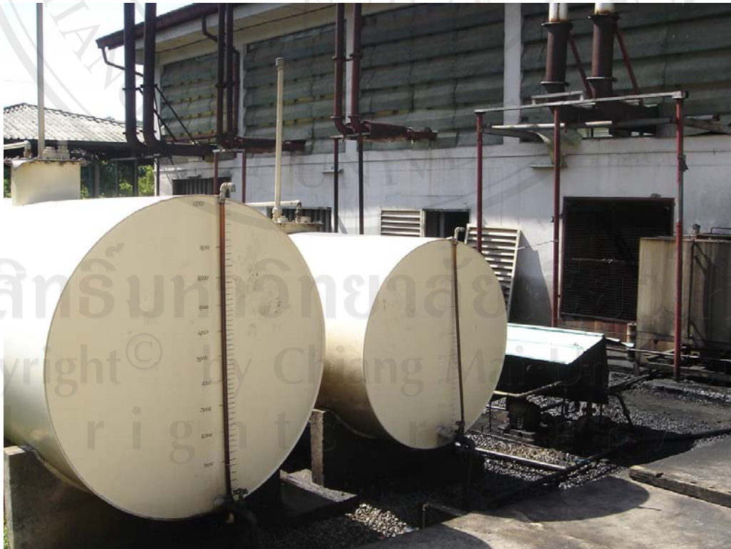
รูป 4.19 ถังเก็บน้ำมันเชื้อเพลิงสำรอง
