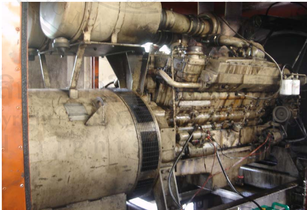
รูป 4.17 เครื่องยนต์ดีเซลกำเนิดไฟฟ้ายี่ห้อ CUMMINS ขนาด 335 กิโลวัตต์
