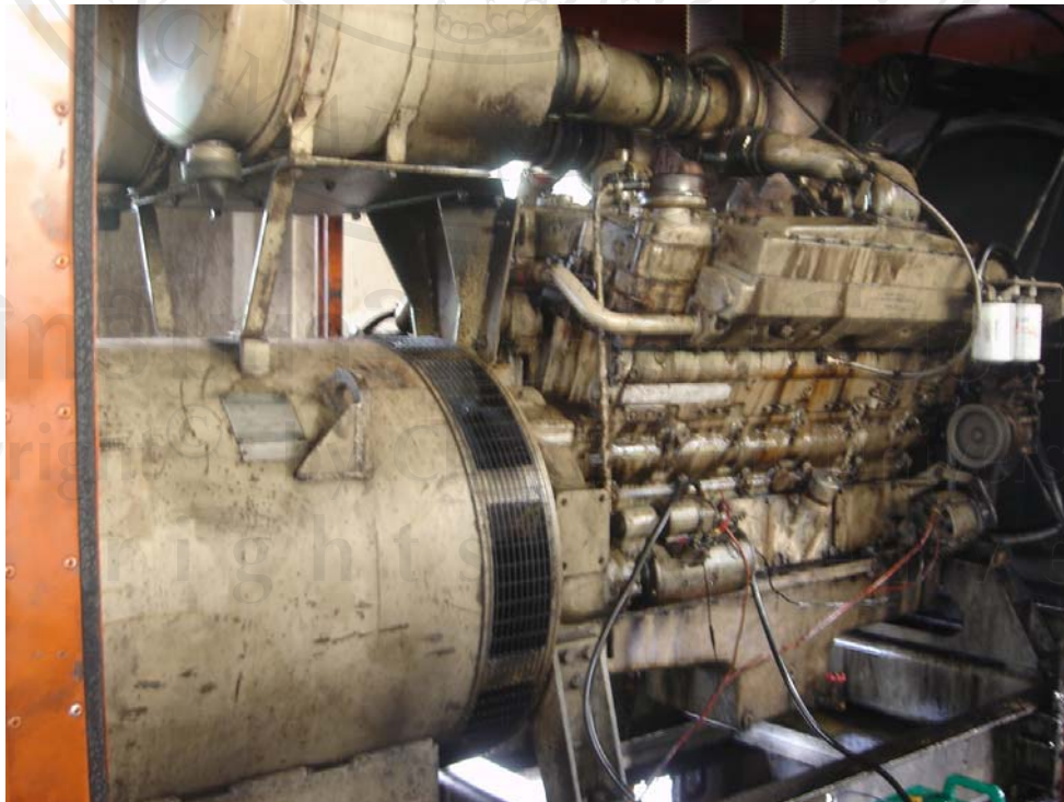
รูป 3.17 เครื่องยนต์ดีเซลกำเนิดไฟฟ้ายี่ห้อ CUMMINS ขนาด 335 กิโลวัตต์
