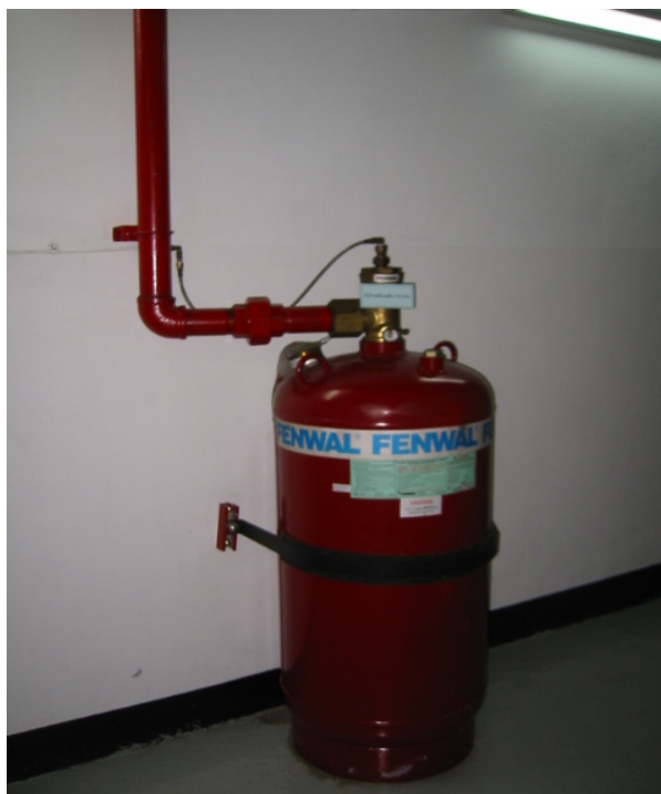
ภาพที่ 4 ลักษณะถังบรรจุสารดับเพลิง HFC 227 ea
