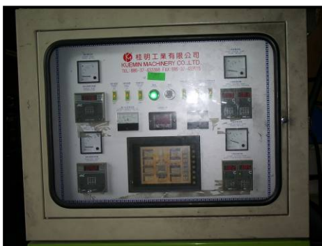
ภาพที่ 23 แผงควบคุมเงื่อนไขการผลิต (Control Panel)
