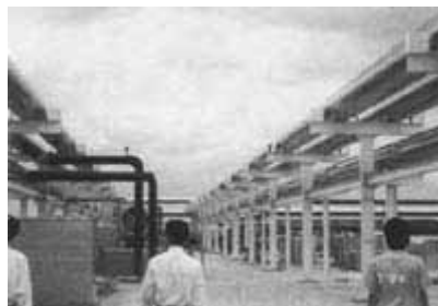
ภาพที่ 7 ระบบท่อน้ำเย็น
