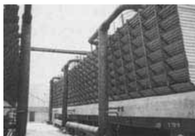
ภาพที่ 8 หอระบายความร้อน (Cooling Tower)
