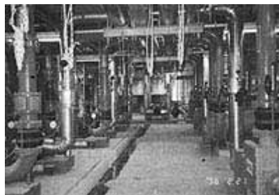
ภาพที่ 6 ภายในห้องเครื่องทำน้ำเย็น
