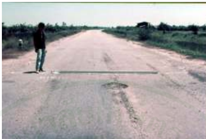
ภาพที่ 1 ลักษณะการแตกร้าวของคันโครงสร้างชั้นทางที่ก่อสร้างบนฐานรากดินเหนียวอ่อน
