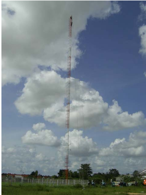
รูปที่ A7 แสดงเสาวัดลมที่สถานีกัมปงรม
