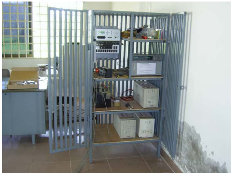
รูปที่ A8 แสดงเครื่องบันทึกข้อมูลที่สถานีกัมปงรม
