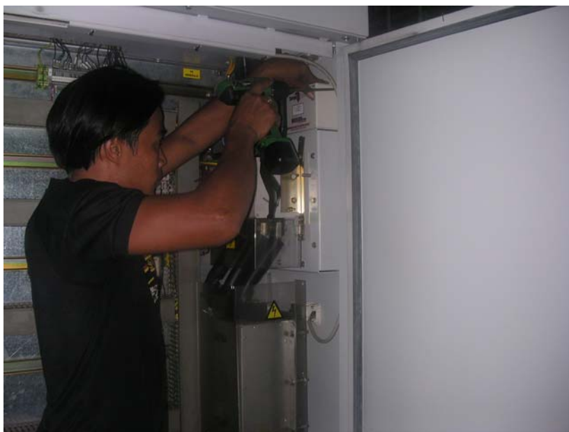
ภาพผนวกที่ 20 ต่อ SPD ก่อน Breaker ชุด Capacitor
