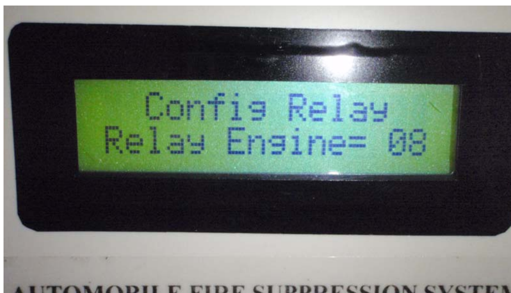
ภาพที่ 34 เมื่อทำการป้อนค่าหน่วยเวลาการสั่งฉีดสารดับเพลิงหลังจากระบบตัดการทำงานของเครื่องยนต์ 8 วินาที
