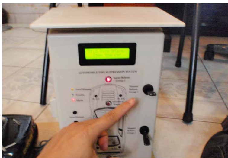
ภาพที่ 43 แสดงการสั่งฉีดสารดับเพลิงในพื้นที่ห้องเครื่องยนต์โดยสวิทช์ Manual Release Zone1
