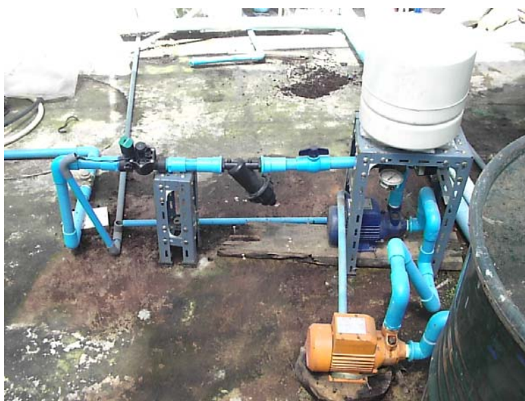
ภาพผนวกที่ ก8 การติดตั้งปั๊มและระบบท่อสำหรับการทดลองเปรียบเทียบผลการเจริญเติบโตของกล้วยไม้จากการใช้วิธีการให้น้ำต่างกัน ในภาพสำหรับหัวจ่ายน้ำไมโครสเปร์ย์
