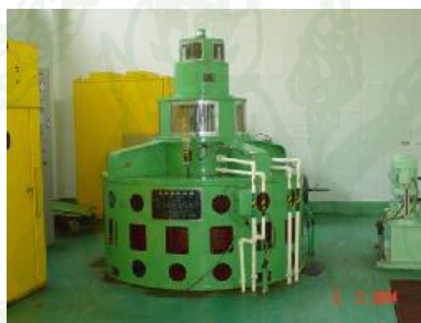
ภาพที่ 26 เครื่องกังหันน้ำและเครื่องกำเนิดไฟฟ้าแบบคาปาล
