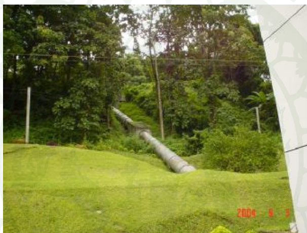
ภาพที่ 24 ท่อส่งน้ำ โครงการไฟฟ้าพลังน้ำแม่ฮ่องสอน
