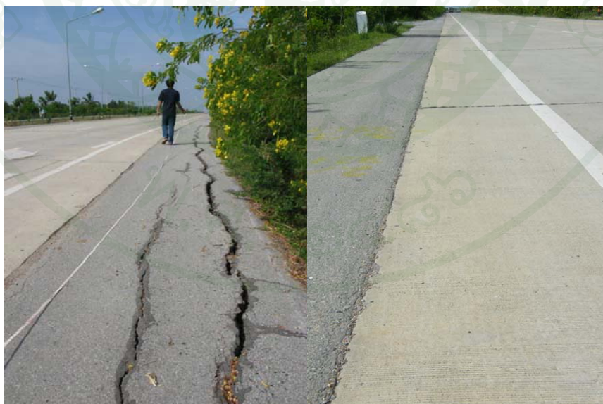
ภาพที่ 42 พื้นที่บริเวณซึ่งพบรอยแตกและการทรุดตัวของบริเวณไหล่ทางที่รุนแรงกับบริเวณซึ่งไม่พบรอยแตกหรือรอยแตกบริเวณไหล่ทางไม่มีความรุนแรง
