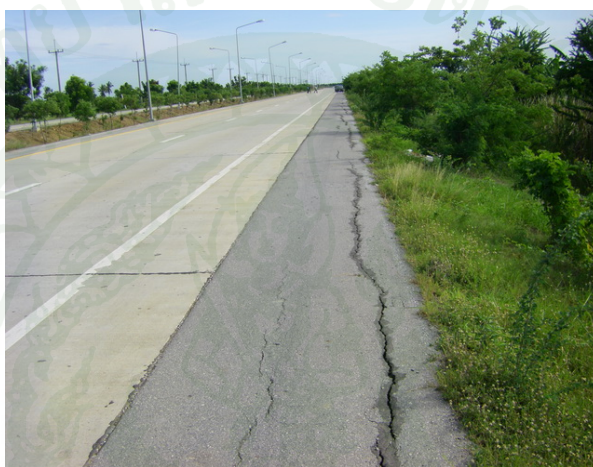
ภาพที่ 33 ลักษณะรอยแตกแนวขอบผิวทาง (Edge Crack)
