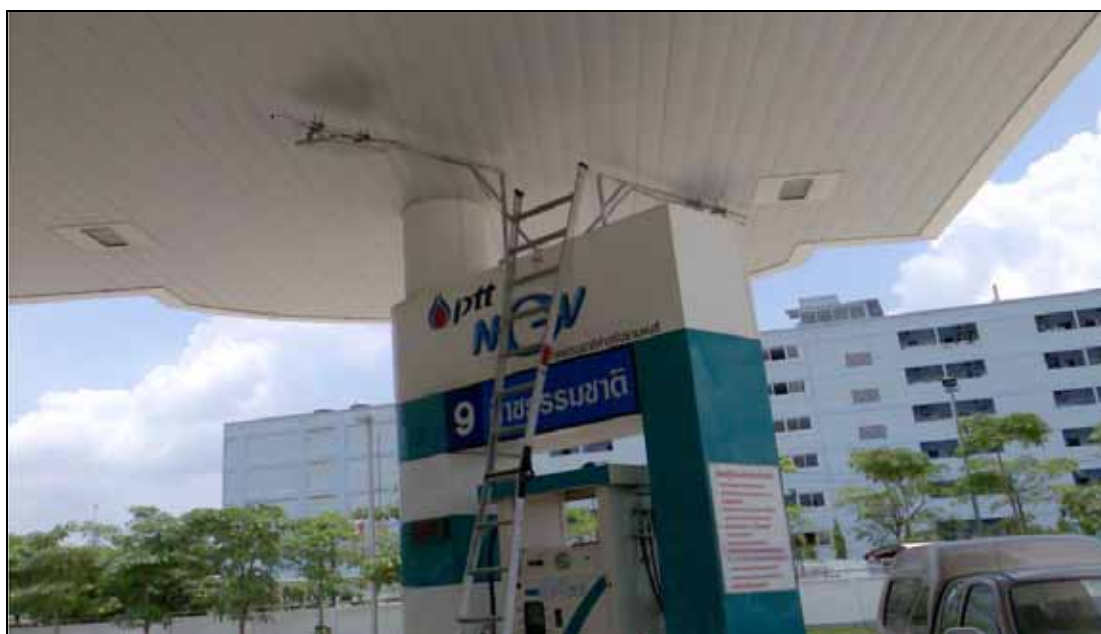
ภาพที่ 13 การวางตำแหน่งของเสาอากาศที่ฝ้าเพดาน
