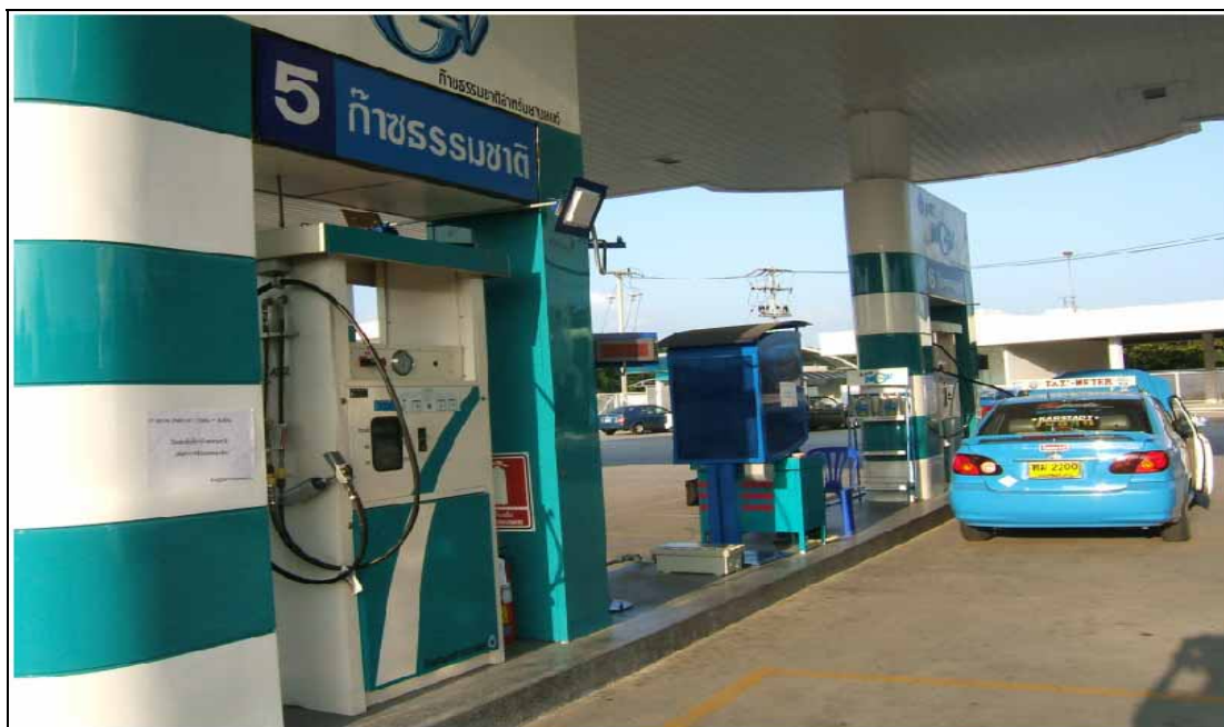
ภาพที่ 12 การวางตำแหน่งของเสาอากาศที่ตู้จ่าย ณ สถานีบริการแก๊สธรรมชาติหลักรังสิต
