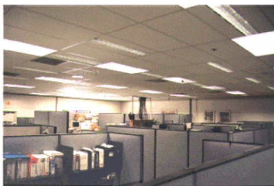
ภาพที่ 14 แสดงการใช้ระบบท่อนำแสงในสำนักงาน
