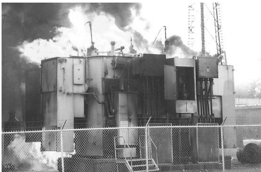
ภาพที่ 8 ตัวอย่างภาพเพลิงไหม้หม้อแปลงไฟฟ้า
