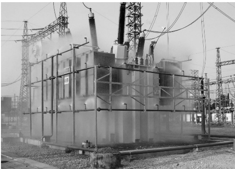
ภาพที่ 9 แสดงการทำงานของระบบ Water Spray
