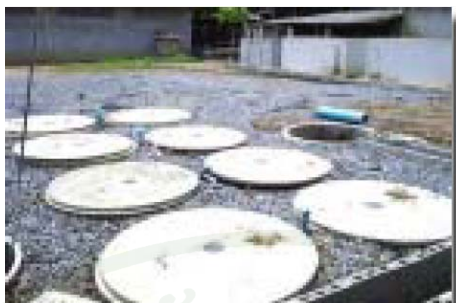
ภาพที่ 2 ระบบบำบัดแบบถังกรองไร้อากาศ
