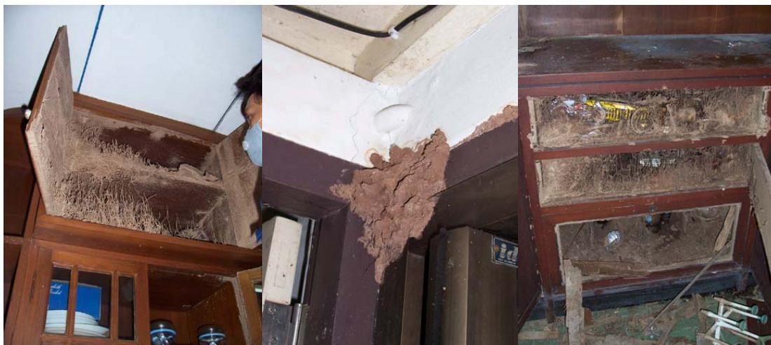
ภาพที่ 4 ความเสียหายภายในตัวอาคารที่เกิดจากปลวกใต้ดิน
