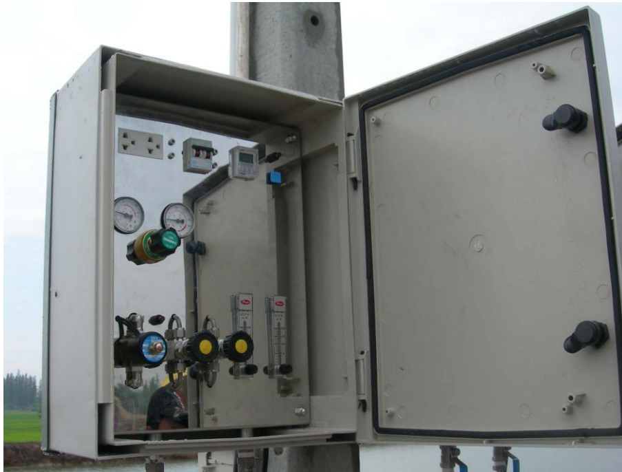
ภาพที่ 7 ตู้ควบคุมการเปิด-ปิด ก๊าซออกซิเจน
