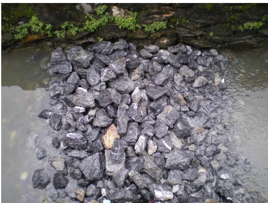
ภาพผนวกที่ ก2 ลักษณะของฝายหินเรียงที่ใช้ในการทดลองบำบัดน้ำเสียของเทศบาลตำบลห้วยยอด อำเภอห้วยยอด จังหวัดตรัง
