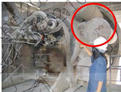
ภาพที่ 5 บริเวณ Satellite cooler
